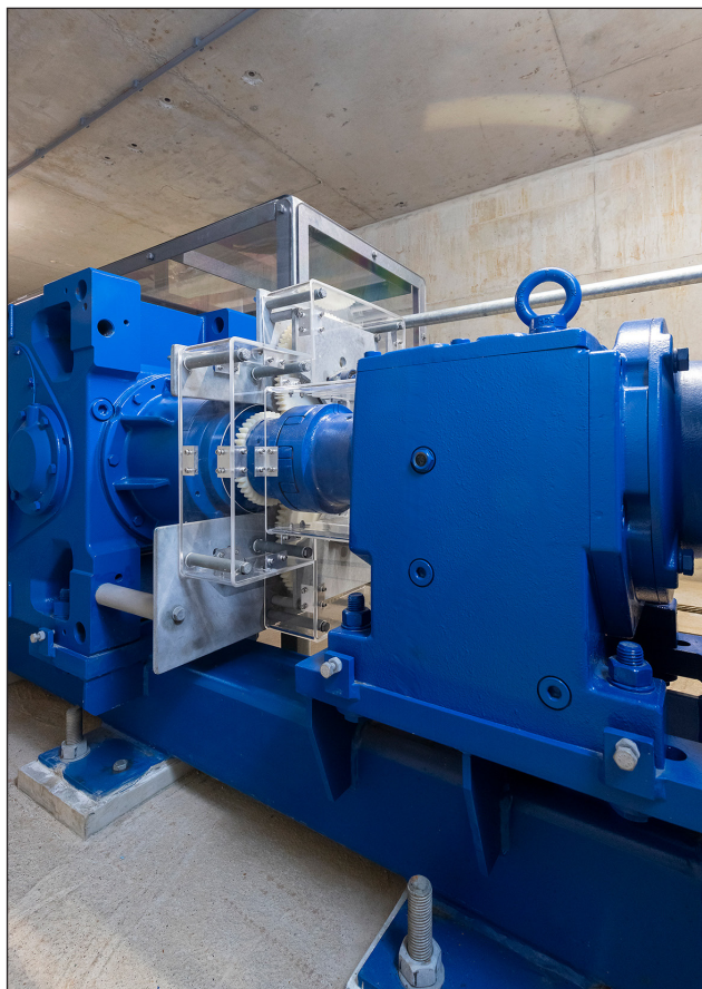
De co-axiale tussenreductor en koppeling.
